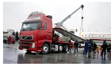
Samolot został opuszczony na naczepę znajdującą się pod skrzydłami, które zostały odkręcone
